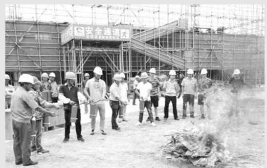
7月24日,北大培文项目工地进行消防演习。演习当天,邀请消防大队、织南派出所来工地指导安全工作。(张海)
